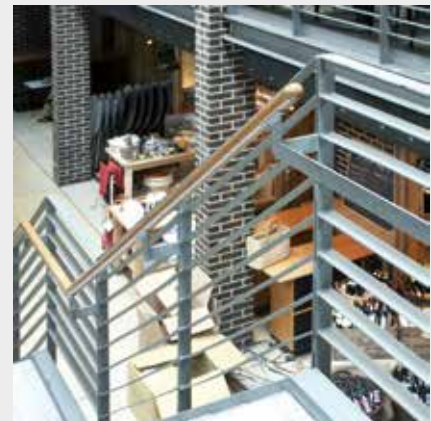
Der Handlauf ist entsprechend DIN 18040 in 85 cm Höhe auf der Innenseite des Geländers angebracht, die Brüstung selber ist höher
