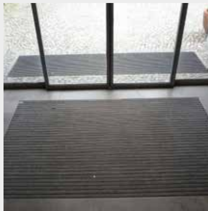
Der Belagwechsel (Fußabtreter) dient Menschen mit Sehbehinderungen auch als taktiler Hinweis auf die automatische Schiebetür
