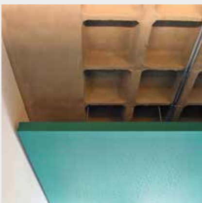
Die abgehängte Decke mindert mit Hilfe von Schalldämmplatten Reflexionen und verbessert somit die Raumakustik
