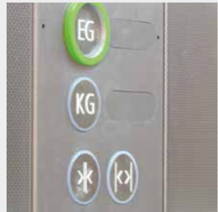
Diese Tasten, darunter die Erdgeschoss-taste (Gebäudeausgang), sind für blinde Menschen gut tastbar
