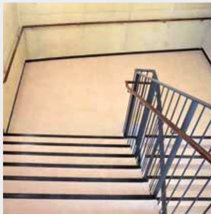
Ein um das Treppenpodest herumgeführter Handlauf bietet Orientierung und Sicherheit für Menschen mit Einschränkungen des Sehens oder der Motorik
